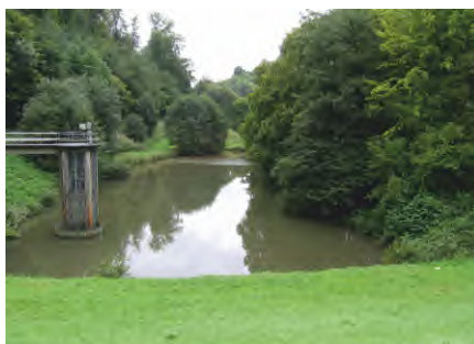
HRB Jugenheim mit Bedienungssteg bei Normalstau
