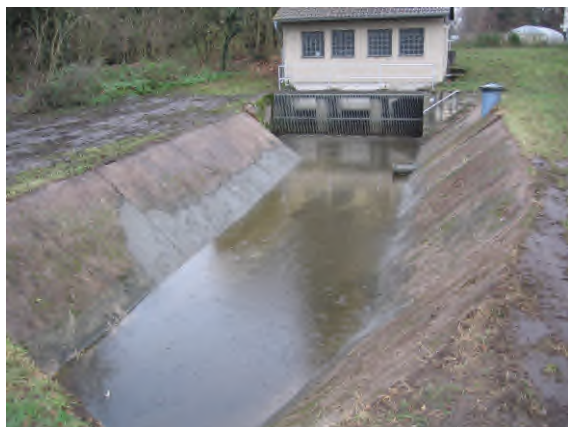
Pumpstation Lohraingraben zulaufseitig
